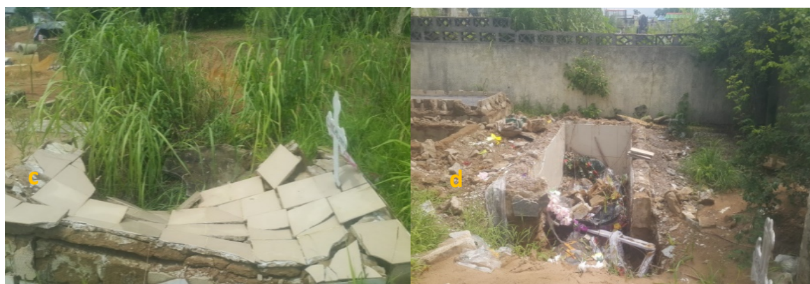
Figure 13 c et 13d : Effondrement suite à l'infiltration des eaux du ruissellement
